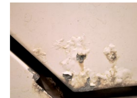
Lackskador som medfört rostangrepp.
