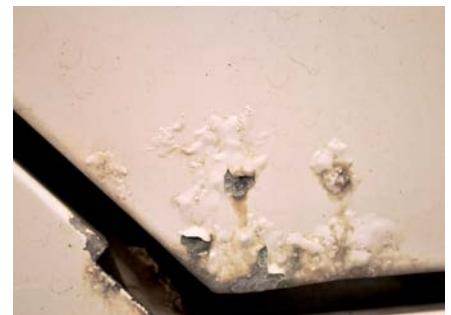
Lackskador som medfört rostangrepp.
